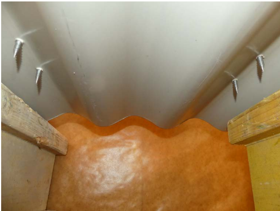
Bild 8: Unterseite von System 1 ohne sichtbaren Wasseraustritt an den Bohrschrauben
