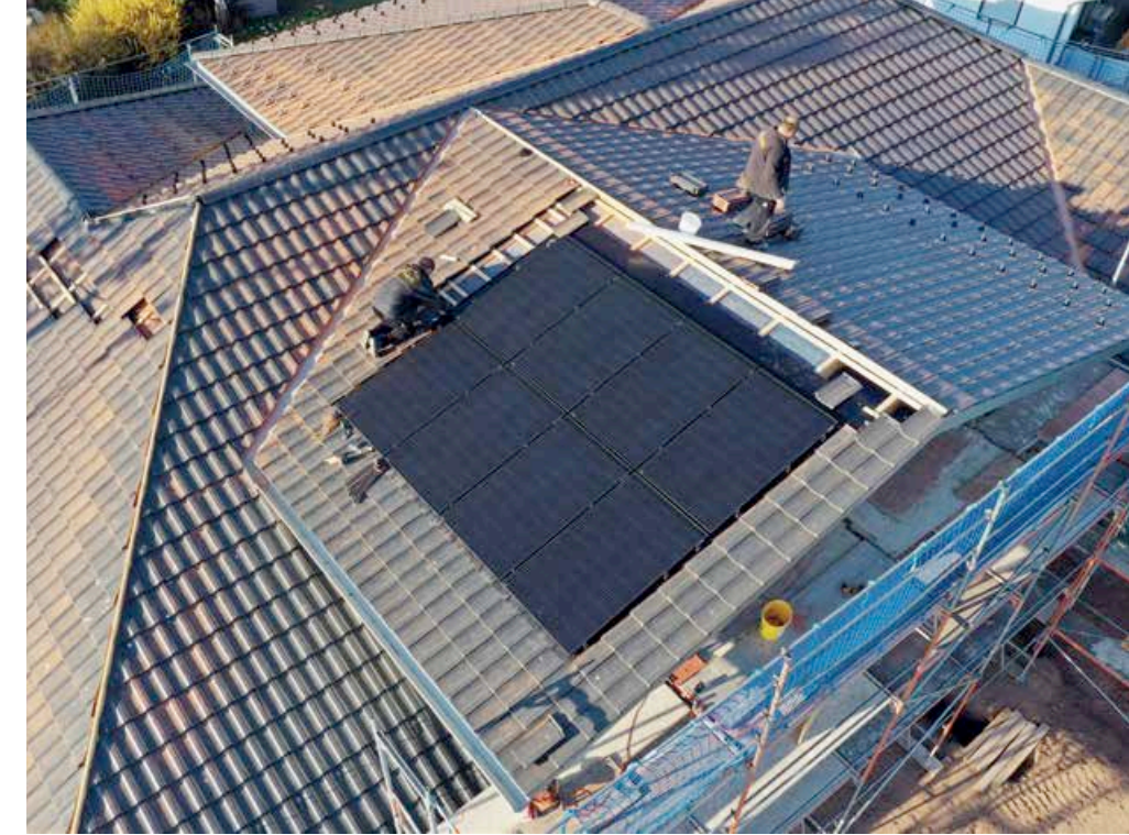
▲ Idealer Standort: Die PV-Module wurden auf zwei nach Süden orientierten Dachflächen montiert
